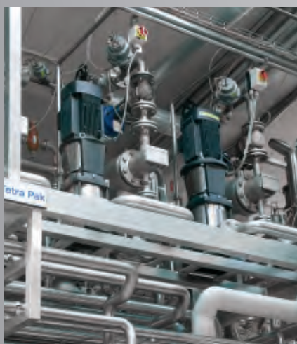
Bombas CR instaladas en planta de productos lácteos
