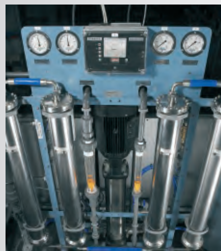
CRN 5 instalada en una planta de tratamiento de agua
